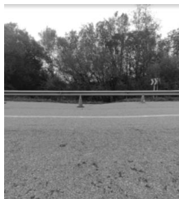
Fotografía 1: afundimento existente na calzada
