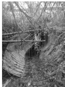
Fotografía 2: entrada do tubo onde se ve como parte da auga se perde cara o lateral esquerdo
