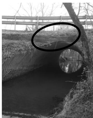
Fotografía en la que se señala la deformación en el hastial
