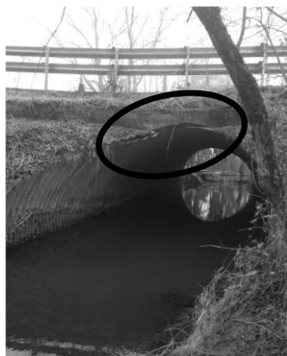
Fotografía en la que se señala la deformación en el hastial
