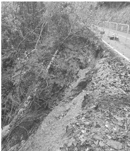
Rotura de terraplén en la LU-P-4806.
