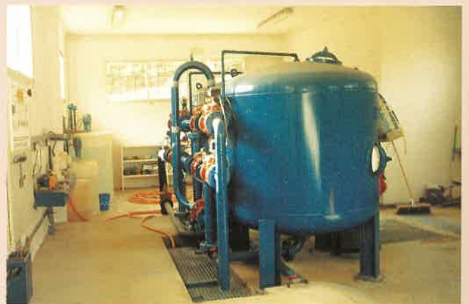
Estación de Bombeo.
