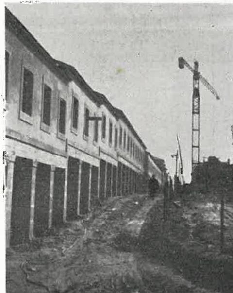
Aspecto de las obras de construcción de uno de los grupos de viviendas
